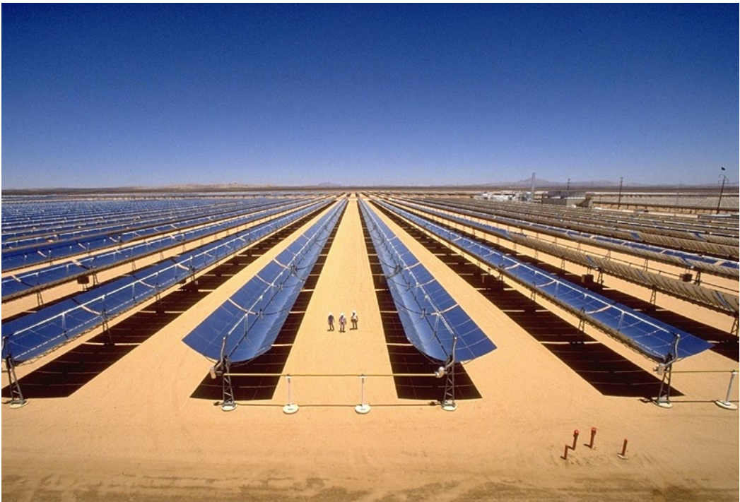
Figura 9. Campo solar de Calha Parabólica no deserto Mojave, Califórnia, Estados Unidos
