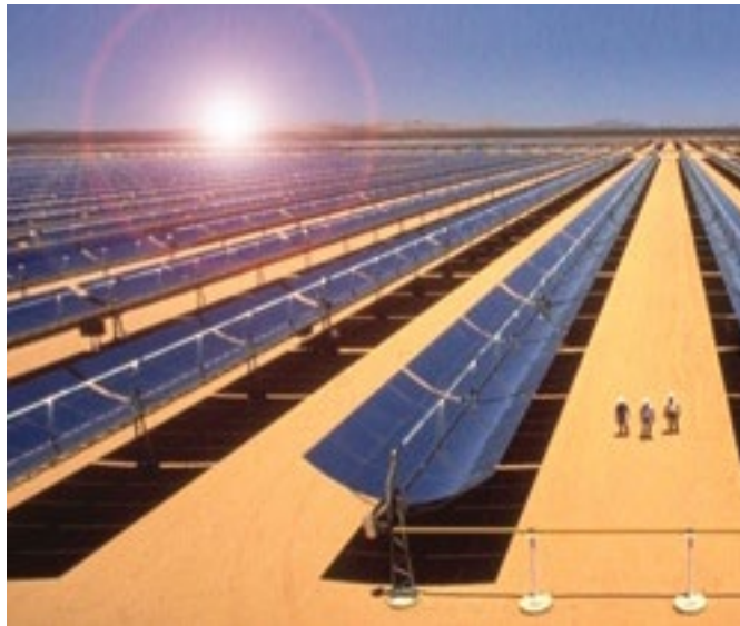
Figura 16. Campo solar de Calha Parabólica no deserto Mojave, Califórnia, Estados Unidos.
